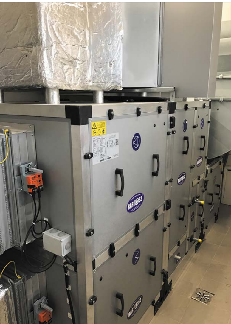
Przedszkole w Warszawie – dostawa sekcyjnej centrali wentylacyjnej VEBAR CR z wymiennikiem obrotowym o wydajności 5500 m 3 /h
