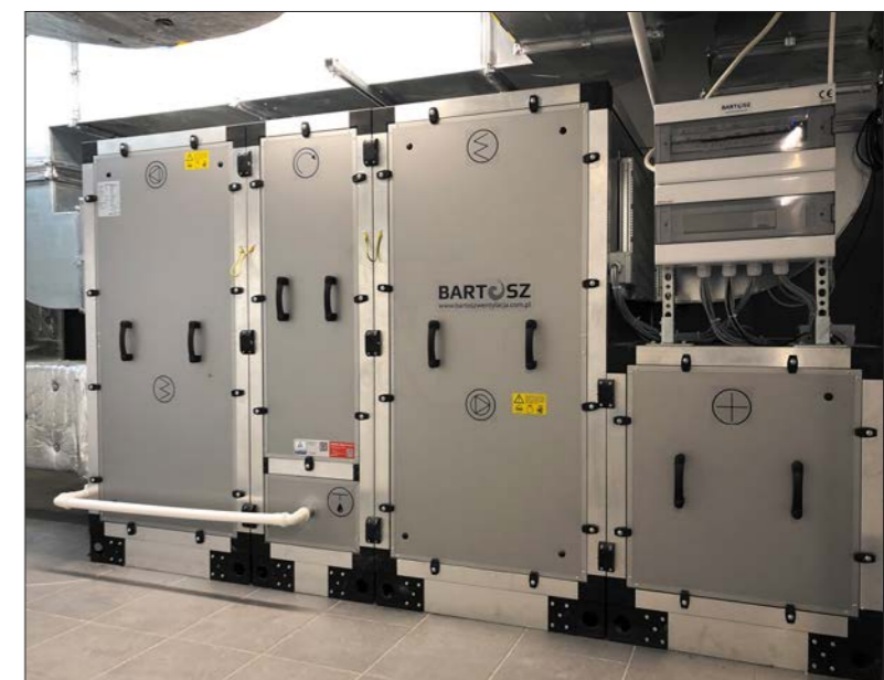
Budynek usługowo-oświatowy w Kleosinie – dostawa centrali wentylacyjnej z wymiennikiem obrotowym VEBAR CR oraz podwieszanej centrali VENA Optima VOV o łącznej wydajności 4700 m 3 /h
