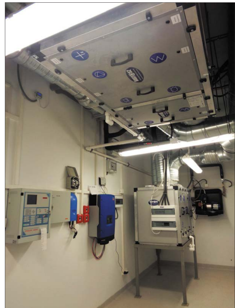
Budynek Laboratoryjno-Badawczy Wydział Architektury Politechniki Białostockiej – dostawa dwóch central wentylacyjnych o łącznej wydajności 1400 m 3 /h. Sterowanie wpięte do nadrzędnego systemu inteligentnego budynku
