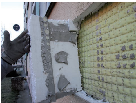
FOT. 3. Istniejące ocieplenie przyklejone prawidłowo, jednak odspojone od podłoża; fol. archiwum autora
