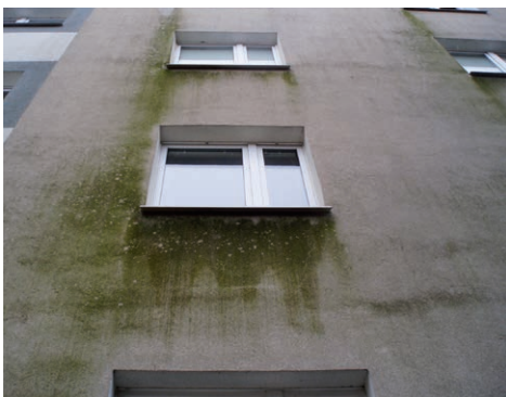
FOT. 23. Ocena stanu skażenia mikrobiologicznego na powierzchni tynków – miejscowo intensywne; fot. archiwum autora
