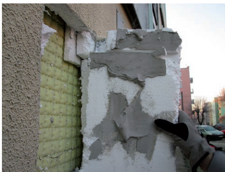
FOT. 2. Istniejące ocieplenie zamocowane nieprawidłowo; fol. archiwum autora
