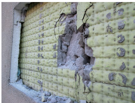
FOT. 14. Odkryte rozwarstwienie ściany nośnej – podłoże z gazobetonu; fot. archiwum autora
