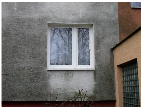
FOT. 22. Ocena stanu zabrudzenia powierzchni tynków – silne zabrudzenie; fot. archiwum autora
