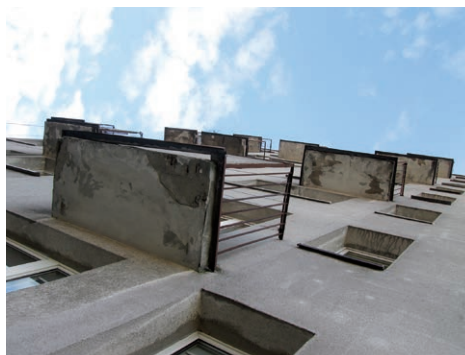
FOT. 20. Uszkodzone płyty balkonowe; fot. archiwum autora
