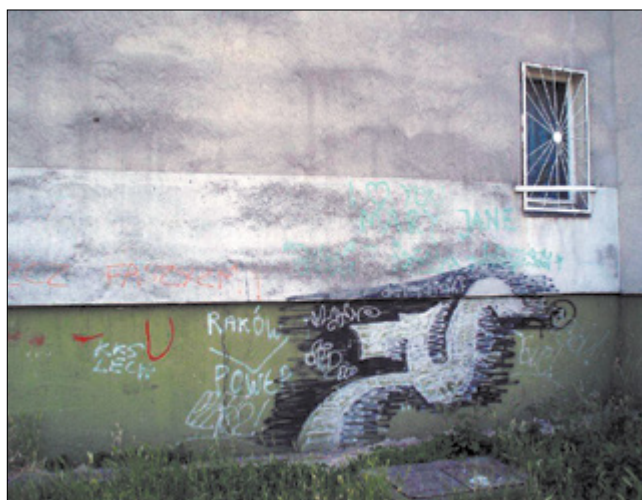
Graffiti na elewacji
