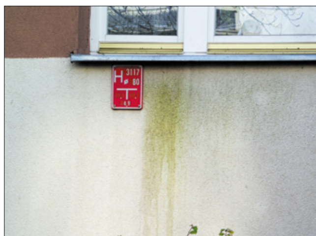
Porażenie biologiczne wyprawy tynkarskiej w miejscu występowania trwałego zacieku spod obróbki blacharskiej podokiennika
