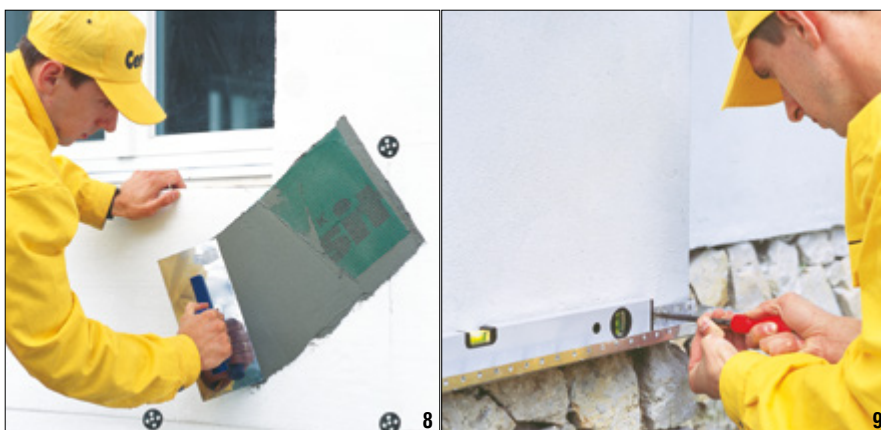
Fot. 6–9. Wybrane etapy prac przy montażu systemów ociepleń: 6 – wspomagające kotwienie, 7–8 – wklejanie siatki (7 – wklejanie profilu w naroże okna, 8 – dodatkowe wzmocnienie siatką strefy przyokiennej), 9 – mocowanie listwy startowej
