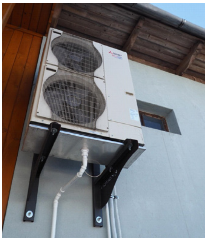
Usytuowanie jednostki zewnętrznej pompy ciepła w starym domu – na ścianie budynku Fot. autor
