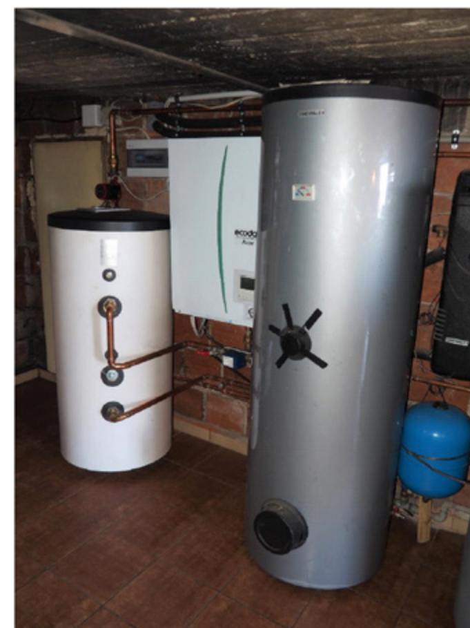
Przykład wykonania powietrznej pompy ciepła w istniejącym budynku Fot. autor
