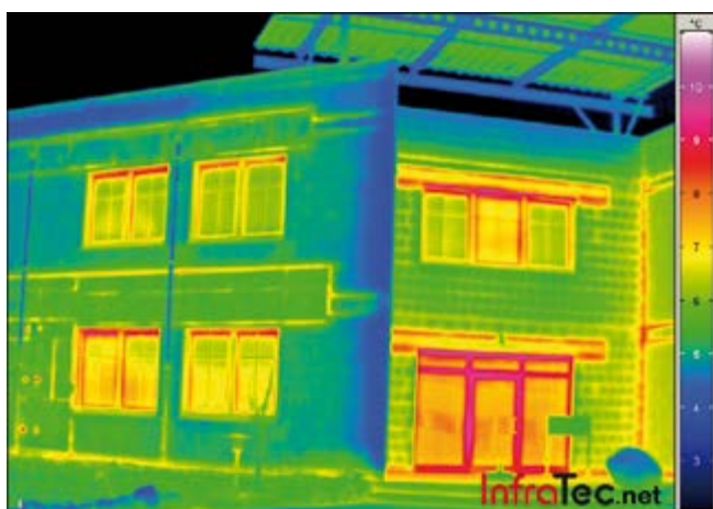
Wadliwie wykonane drzwi i okna
