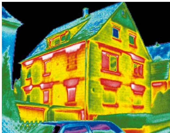
Utrata ciepła przez źle zainstalowane rolety
