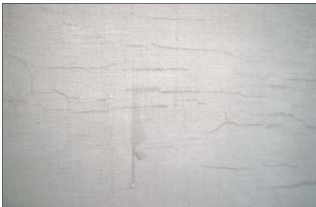
Pęknięcia na warstwie zbrojonej
